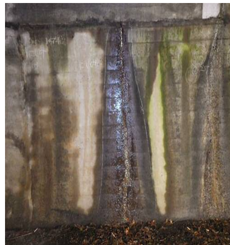
S22 の水平打継目の漏水
