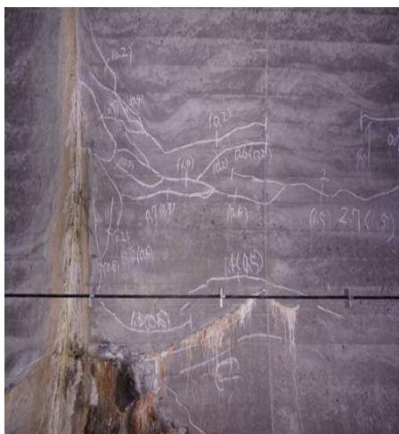
S09 のひび割れ（外力）
