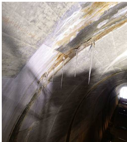
S11 の横断打継目の漏水（つらら）
