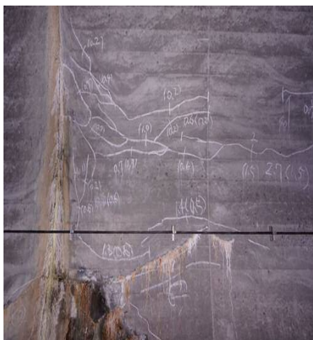
S09 のひび割れ（外力）
