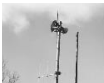
新に設置される無線放送施設
