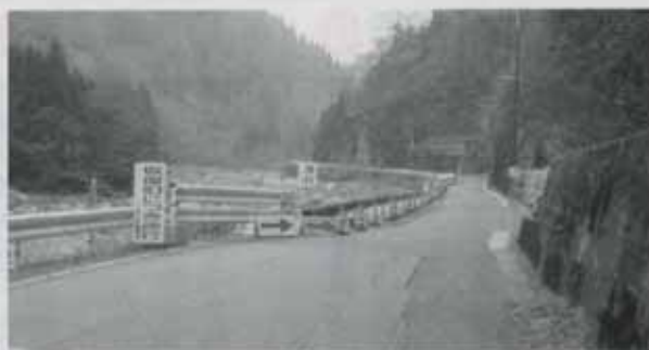
災害復旧できてない県道（十三曲下）
