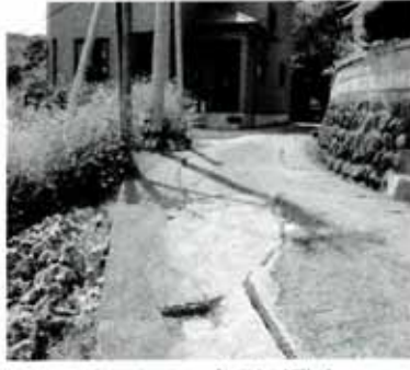
路肩部分に亀裂が発生
