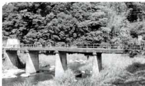
危険橋梁の生竜橋
