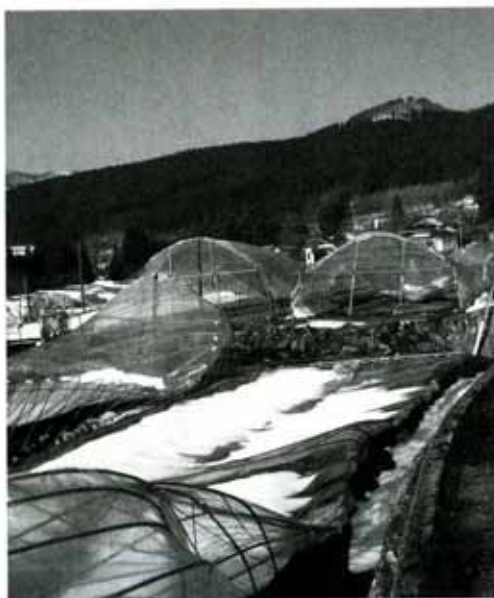
▲大雪で倒壊したビニールハウス
