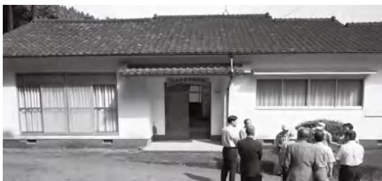
老朽化の進んだ富迫生活改善センター
