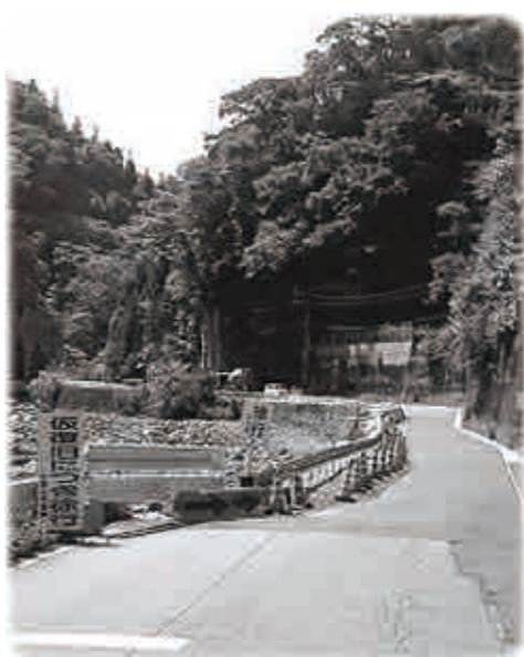
一日も早く復旧が望まれる飯田高原中村線
