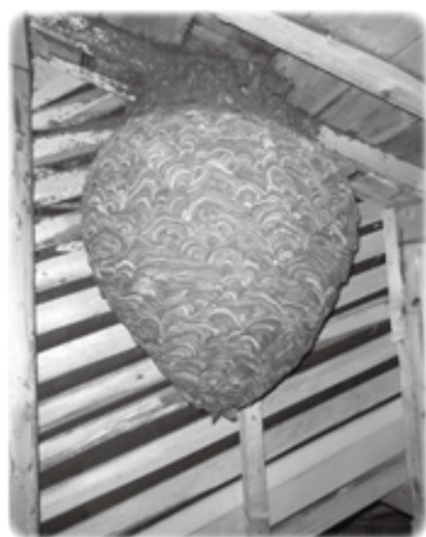
危険と同居 天井裏の巣
