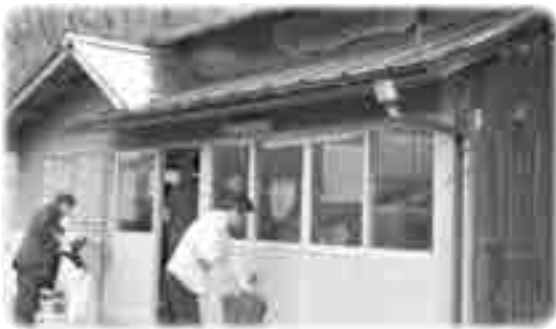
老朽化が進む集会所
