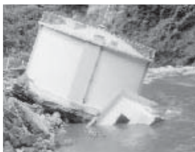
▲野上簡易水道の配水タンクが大きく傾き、断水に
