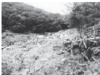
▲大岳発電所付近、大岳地獄への道路が土砂のため、破壊される。
