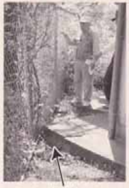
大木の根が床を押し上げひび割れ発生
