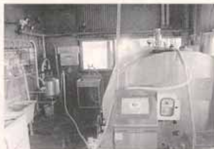
▲搾乳されたミルクはパイプを通じて畜舎横のタンクに集まります。
