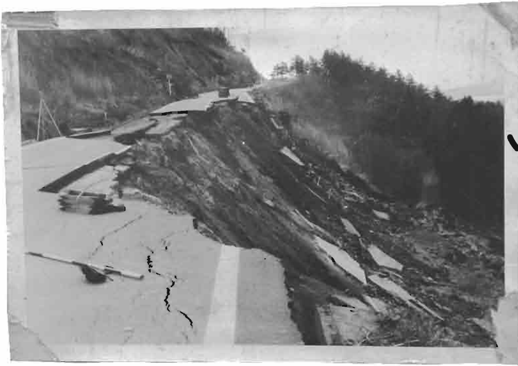
▲1975 大分県中部地震 山下の池付近の道路
