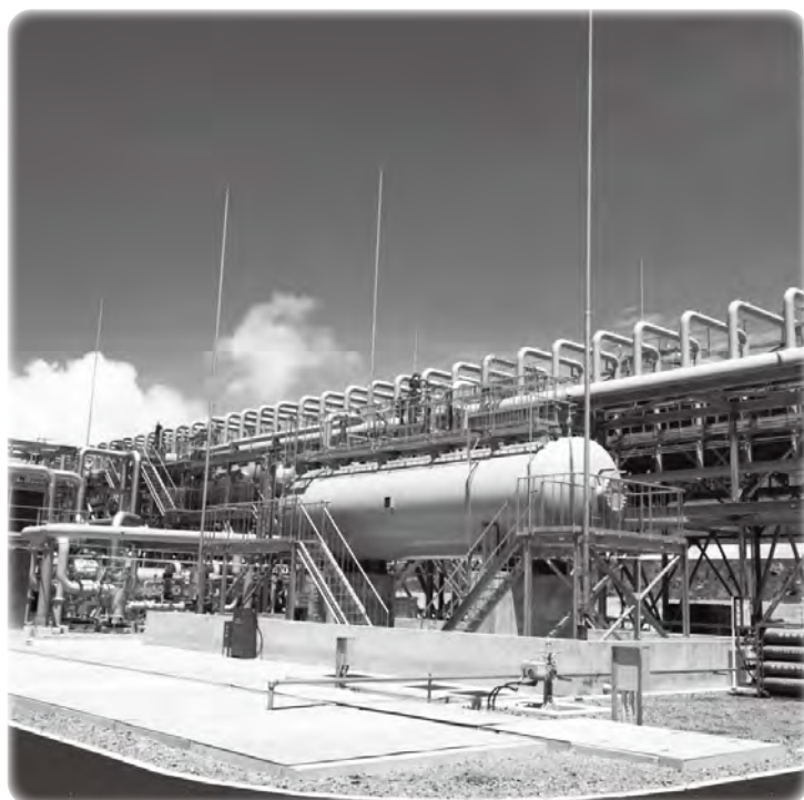
本格稼働から一年経過した菅原バイナリー発電所
