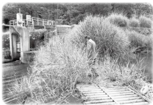
バイパスの取水口を塞ぐ雑草とゴミ
