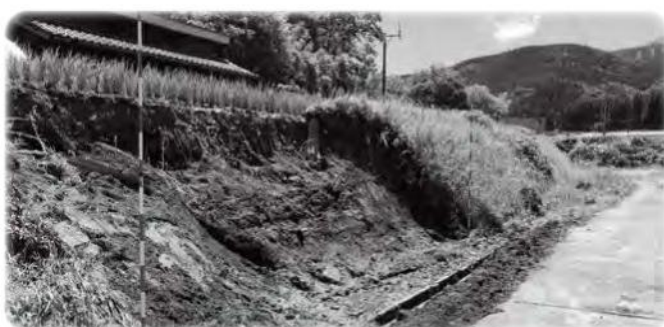
水田法面の災害
