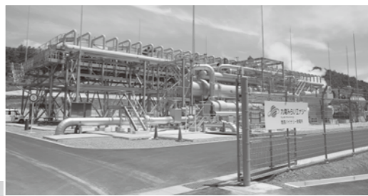
▲菅原バイナリー発電所
