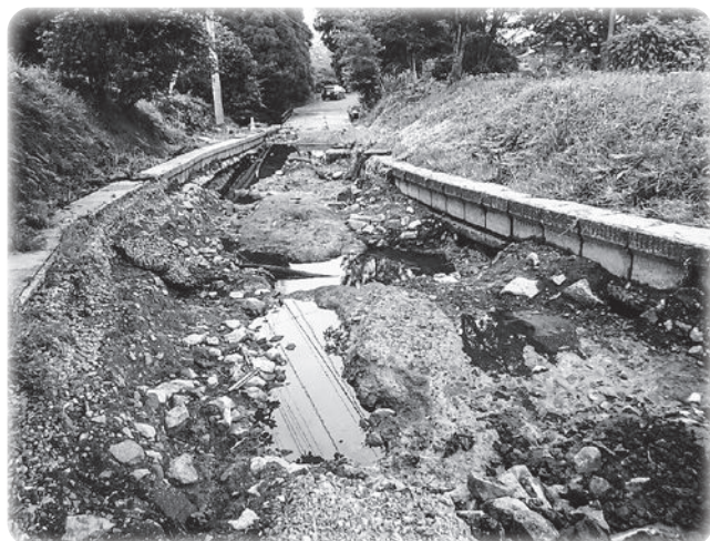
令和2年7月豪雨被害の町道
