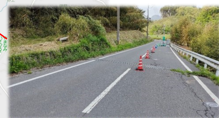
②R4年1月25日から片側交互通行中 路面にひび割れが発生し道路崩壊の可能性あり 対策工法検討中
