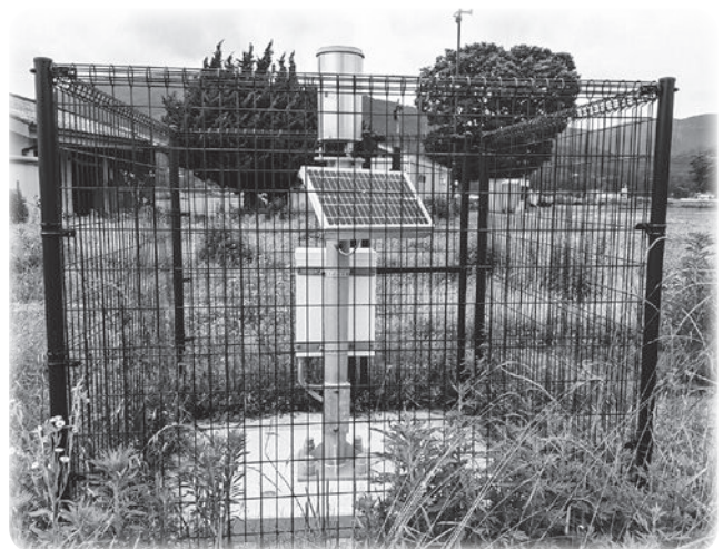
鳴子川水系の東部集会所に設置された雨量計
