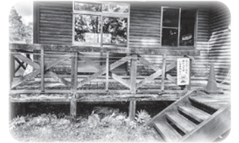
デッキが腐敗して使用できないロッジ
