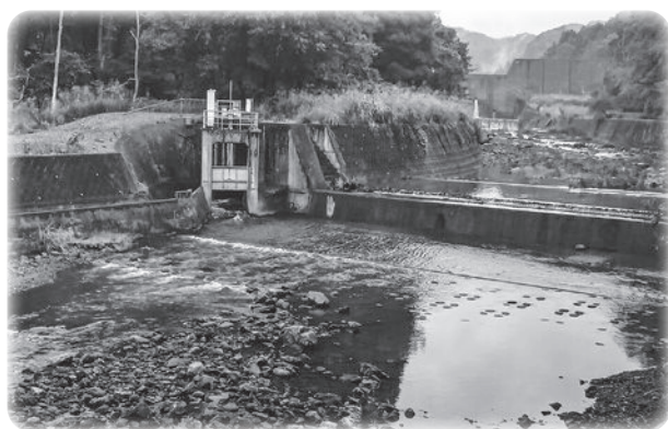
松木ダム付近の水の状況
