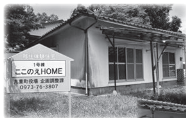
まだ未修理の住宅
